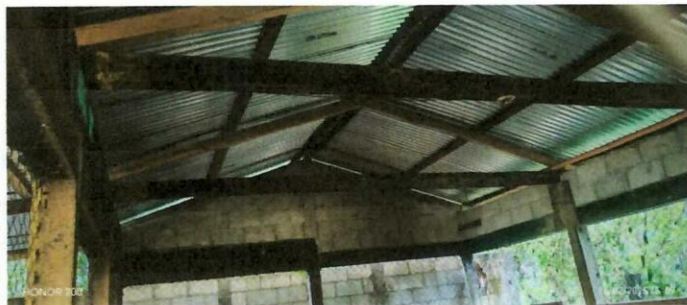
Foto1: La estructura del techo de la cocina es de madera y ya se encuentra deteriorada por lo que es necesario sustituirlo por costaneras
