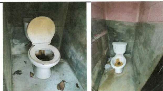
Foto 3: Los servicios sanitarios presentan deterioro por lo que se hace necesario sustituir uno y reparar siete
