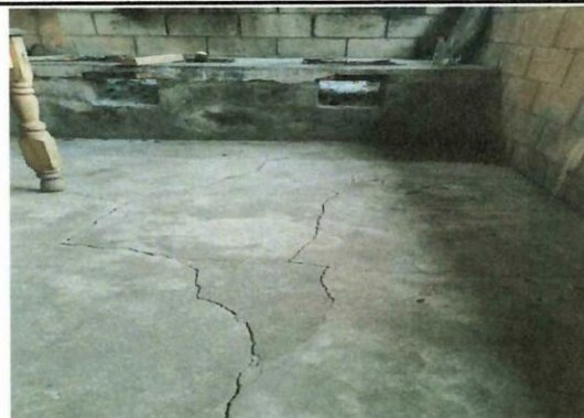
Foto 2: El piso de la cocina se encuentra rajado, por lo que es necesario retirar el entortado y hacerlo de nuevo y colocar piso cerámico
